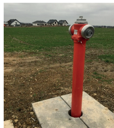
Wodociąg w Żabiej Woli
